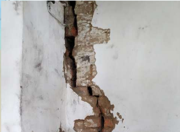
имеется сквозная трещина в печи
