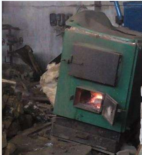
имеется механическое повреждение корпуса котла
