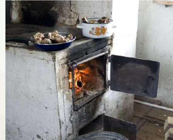
топочная дверца печи неисправна (не закрывается)
