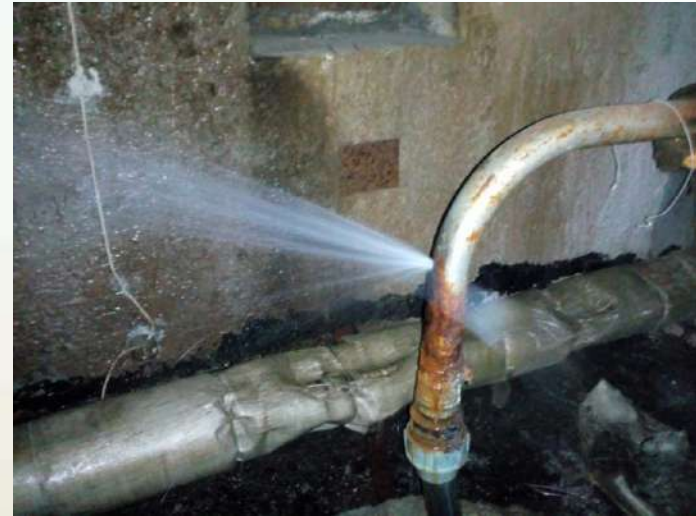
имеется течь из котла
